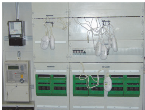
Verteiler mit installierten Sendeeinheiten
