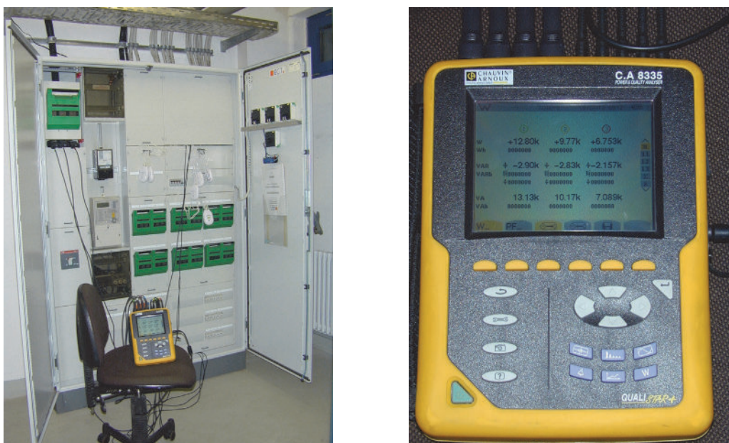
Abbildung 17. Erfassung eines Lastprofils des Stromverbrauchs am Niederspannungshauptverteiler.
