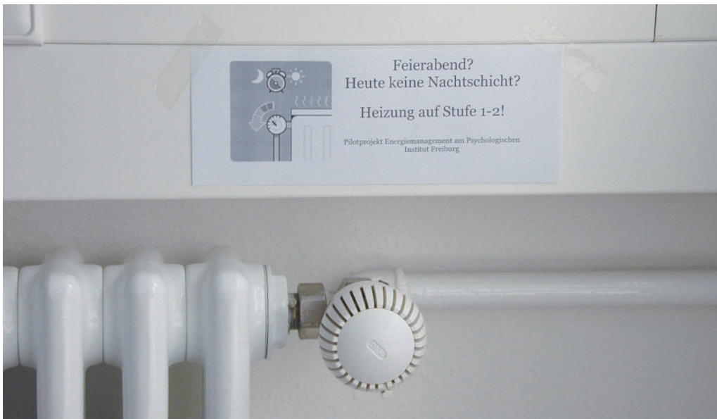
Abbildung 27. Beispiel für einen Appell an das Herunterdrehen der Heizung (Foto: Verf.).
